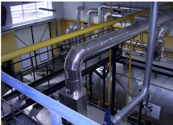
Carlsberg Polska kotłownia parowa o wydajności 44 t/h
